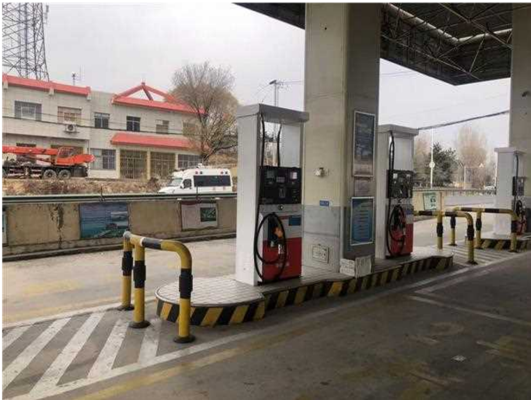
加油站现场照片
