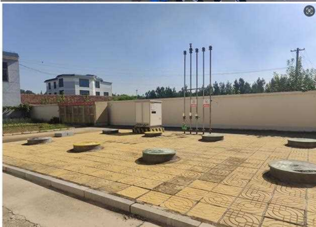
中国石油天然气股份有限公司山东莱芜销售分公司方下镇加油站现场照片
